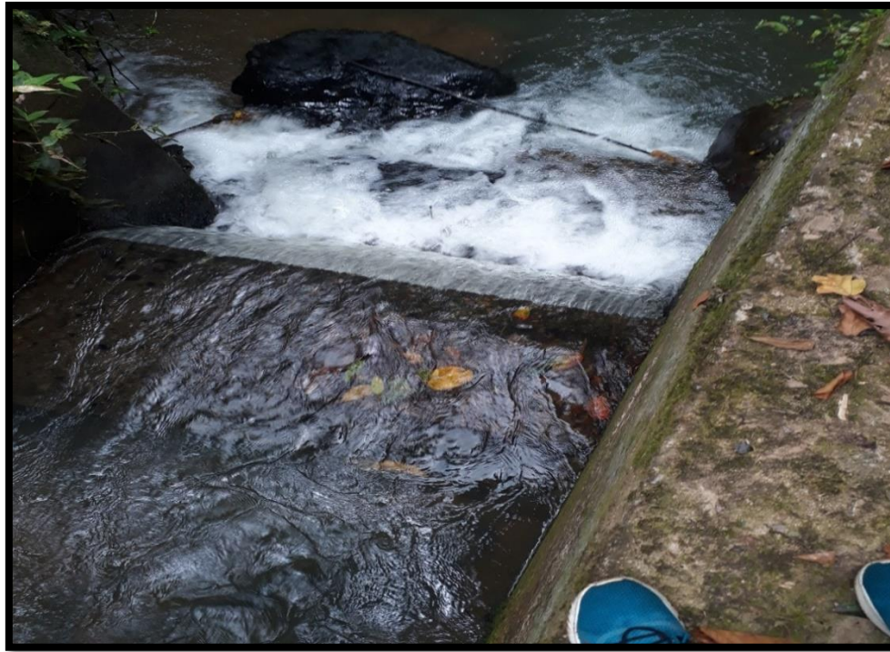
Figura 31 – Bocatoma sobre la quebrada El Lindero
