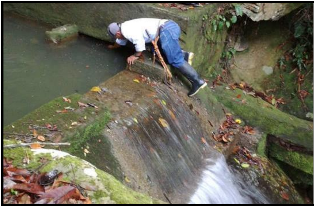
Figura 4 – Bocatoma sobre la quebrada El Lindero
