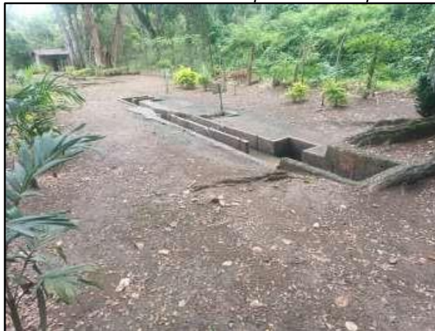
Estructura de entrada PTAR Zapatero-Municipio de Tarqui
