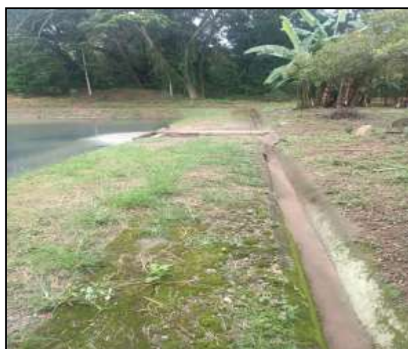
Figura 7. Estructura de Interconexión de flujo entre lagunas en PTAR Zapatero-Municipio de Tarqui
