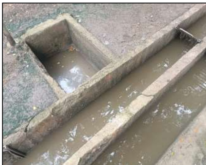
Figura 4. Desarenadores en Paralelo en PTAR Zapatero-Municipio de Tarqui
