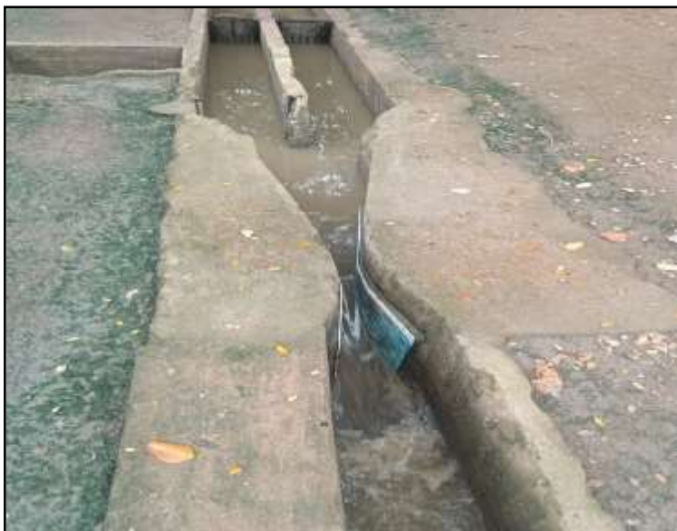
Figura 5. Canaleta Parshall en PTAR Zapatero-Municipio de Tarqui
