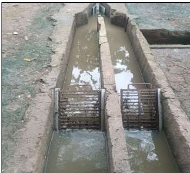
Figura 3. Rejillas de Cribado en PTAR Zapatero-Municipio de Tarqui
