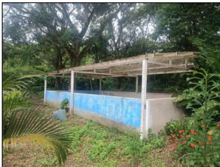
Figura 10. Lecho de Secado en PTAR Zapatero-Municipio de Tarqui
