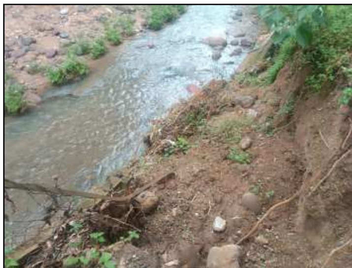
Figura 11. Vertimiento Final en PTAR Zapatero-Municipio de Tarqui
