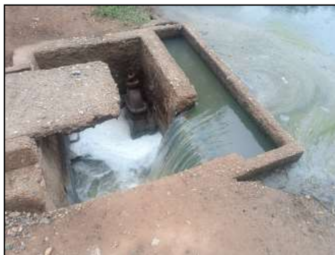
Figura 9. Estructura de Salida en PTAR Zapatero-Municipio de Tarqui
