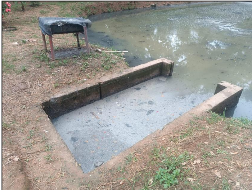
Figura 11. Estructura de Salida en PTAR Zapatero- Municipio de Tarqui Huila
