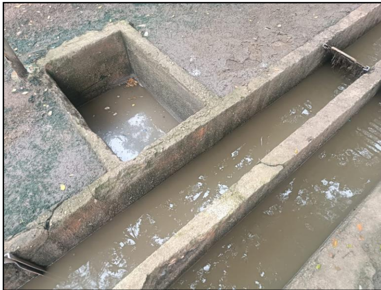
Figura 6. Unidades para desarenado en PTAR Zapatero- Municipio de Tarqui Huila
