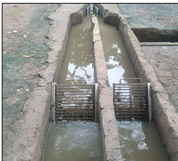
Figura 5. Rejillas de cribado en paralelo en PTAR Zapatero- Municipio de Tarqui Huila.
