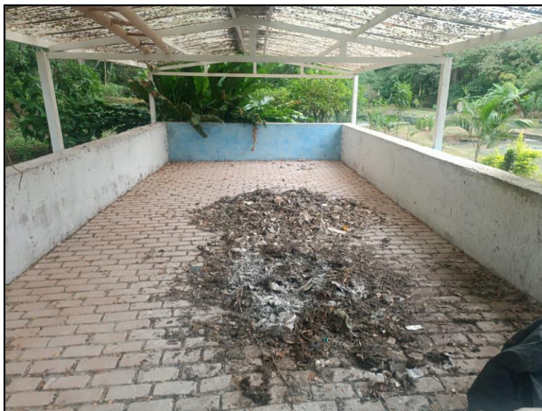
Figura 12. Lecho de secado en PTAR Zapatero- Municipio Tarqui Huila
