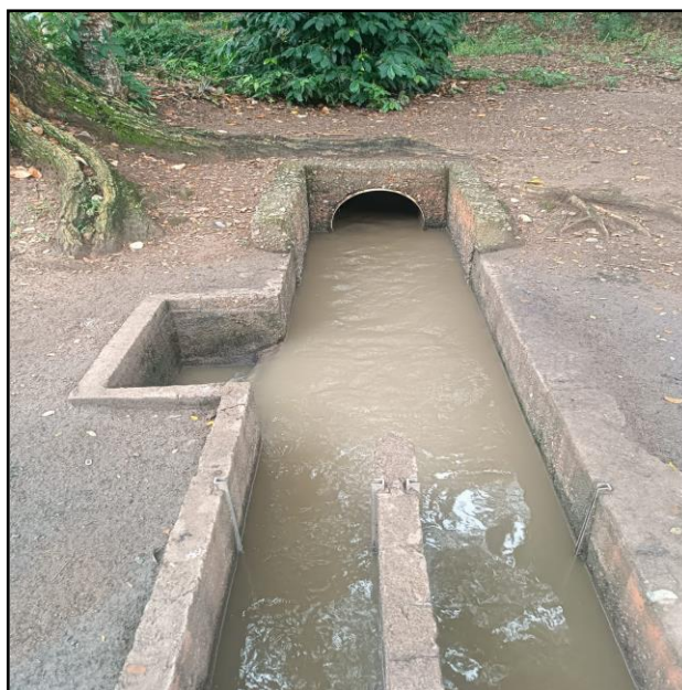
Figura 4. Estructura de entrada en PTAR Zapatero- Municipio de Tarqui Huila.
