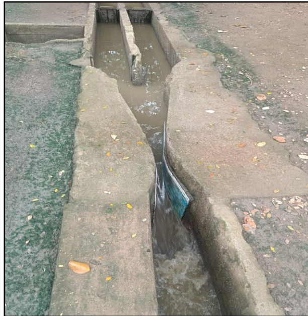
Figura 7. Aforador de caudal- Canaleta Parshall en PTAR Zapatero- Municipio de Tarqui Huila
