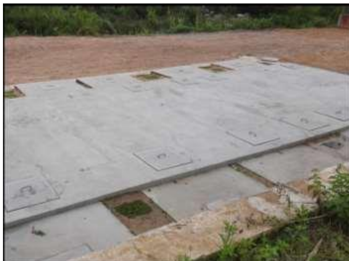
Figura 23. Reactores anaerobios de flujo pistón – RAFP en PTAR La Nueva Santa María
