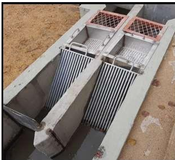
Figura 18. Rejillas de cribado en paralelo en PTAR La Nueva Santa María
