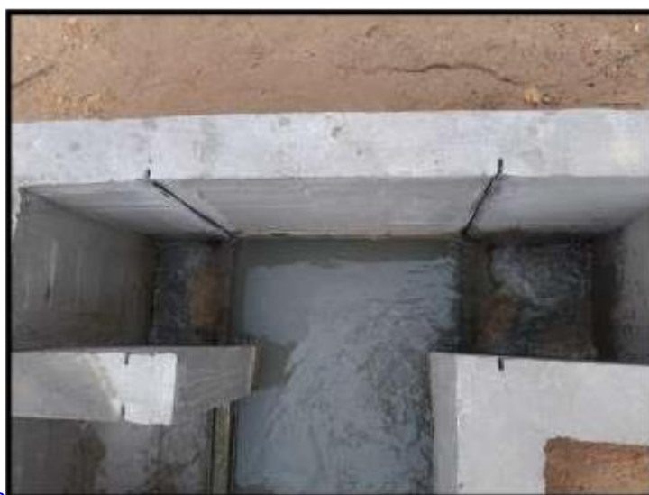
Figura 7. Canal de repartición de caudales en PTAR principal Santa María
