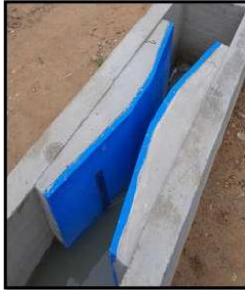
Figura 20. Aforador de caudal – canaleta parshall – en PTAR La Nueva Santa María
