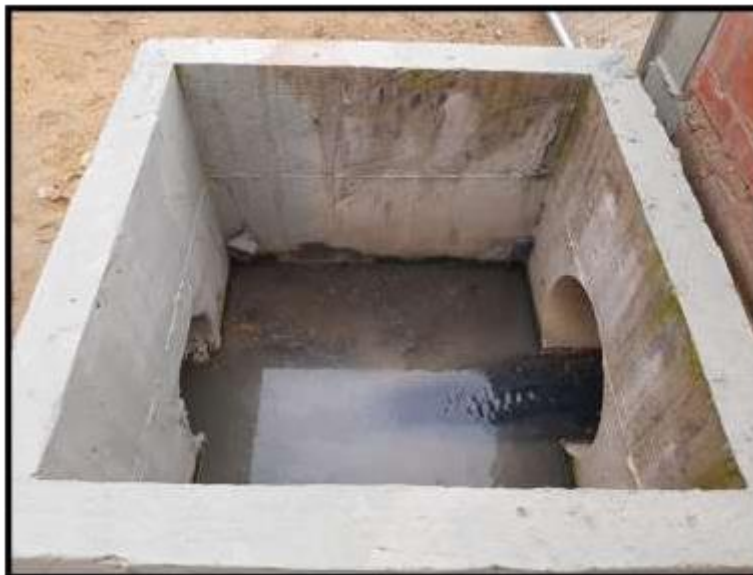
Figura 1. Aliviadero inicial de aguas lluvias en PTAR principal Santa María
