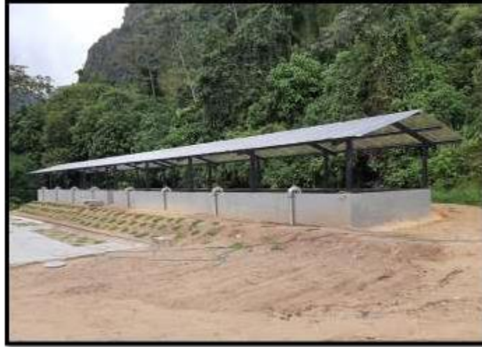
Figura 14. Lechos de secado de lodos en PTAR principal Santa María
