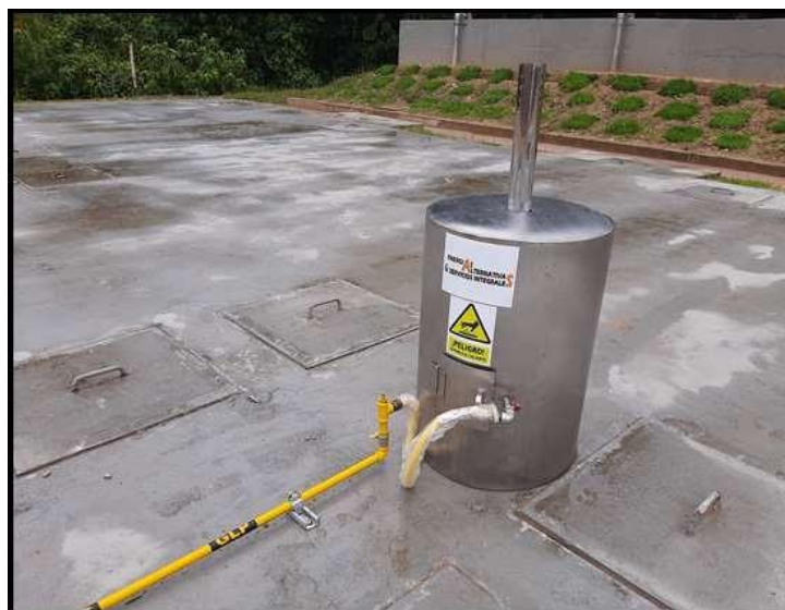
Figura 15. Unidad quemadora de biogás en PTAR principal Santa María.
