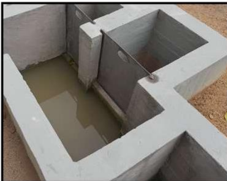
Figura 21. Aliviadero intermedio de aguas con tratamiento primario en PTAR La Nueva Santa María
