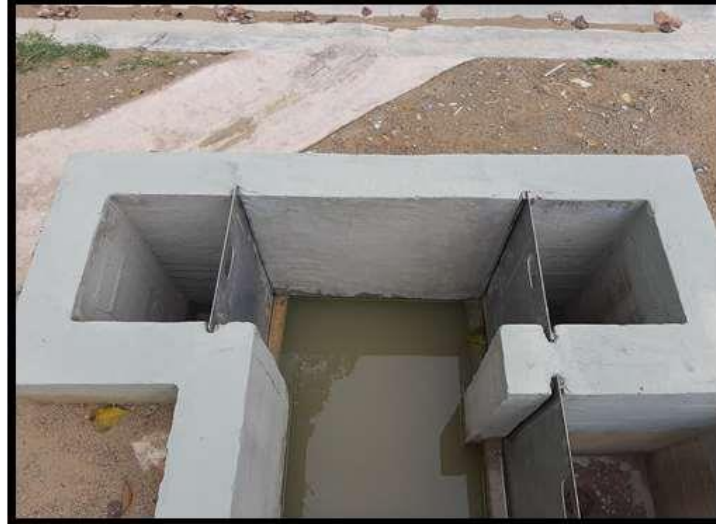
Figura 22. Canal de repartición de caudales en PTAR La Nueva Santa María
