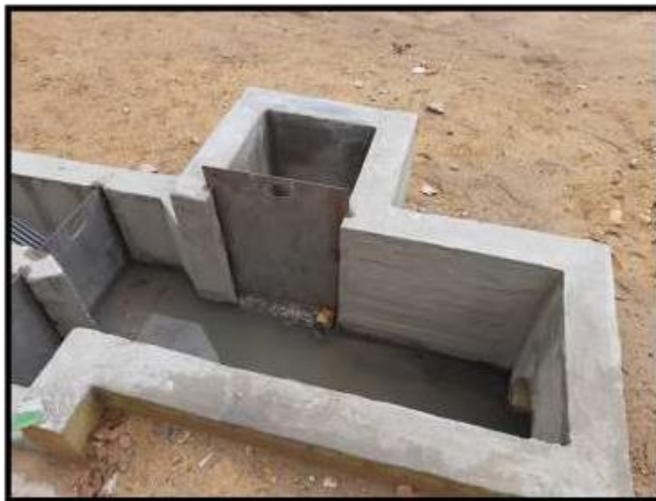
Figura 17. Aliviadero inicial de aguas crudas en PTAR La Nueva Santa María
