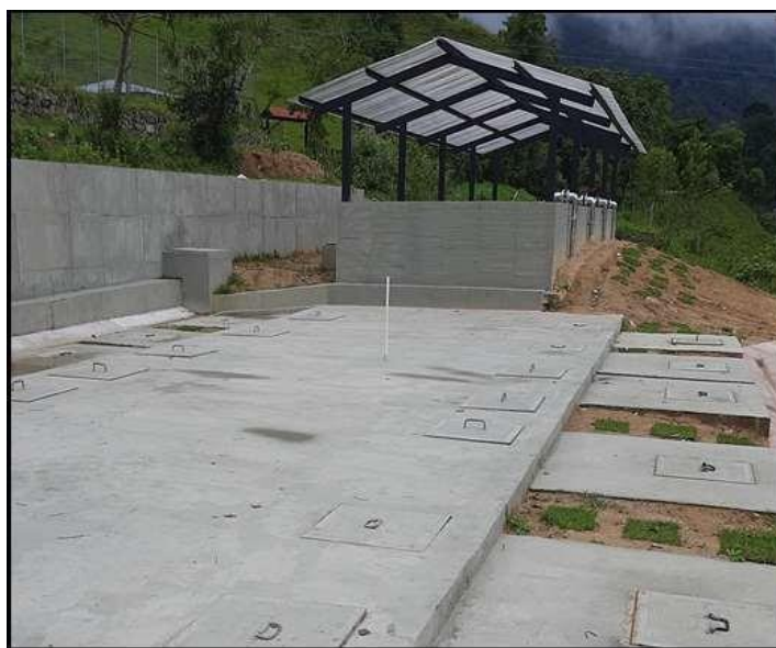
Figura 26. Filtros anaerobios de flujo ascendente – FAFA en PTAR La Nueva Santa María
