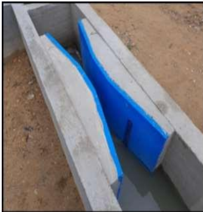
Figura 5. Aforador de caudal – canaleta parshall – en PTAR principal Santa María
