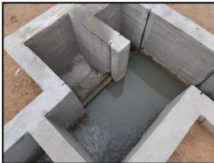
Figura 6. Aliviadero intermedio de aguas con tratamiento primario en PTAR principal Santa María
