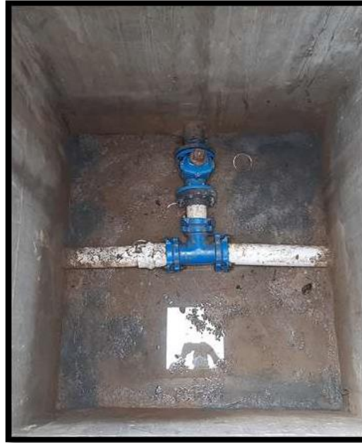
Figura 10. Cajilla de válvulas de lodos del RAFP y FAFA en PTAR principal Santa María
