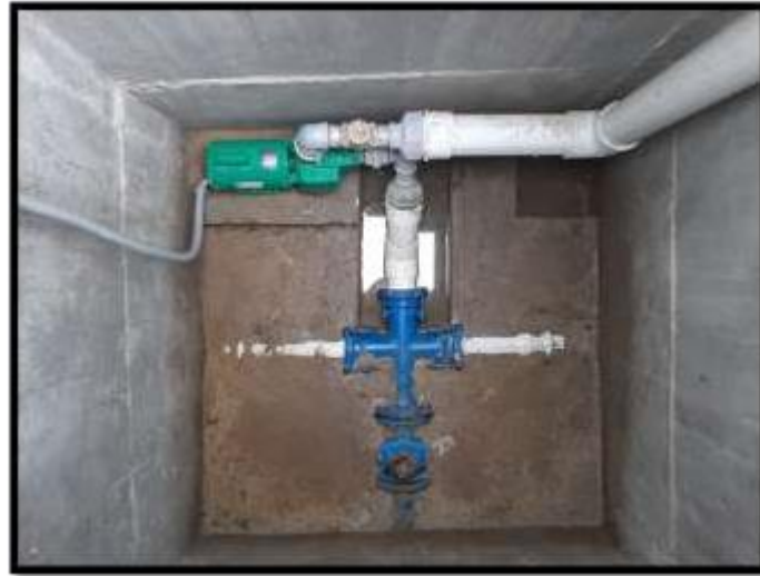
Figura 13. Pozo de bombeo con electrobomba en línea hacia lecho de secado de lodos – FAFA en PTAR principal Santa María
