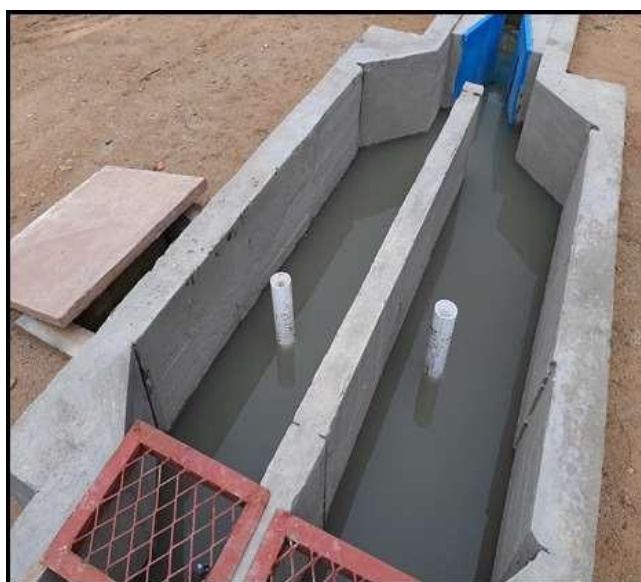
Figura 19. Unidades para desarenado en PTAR La Nueva Santa María
