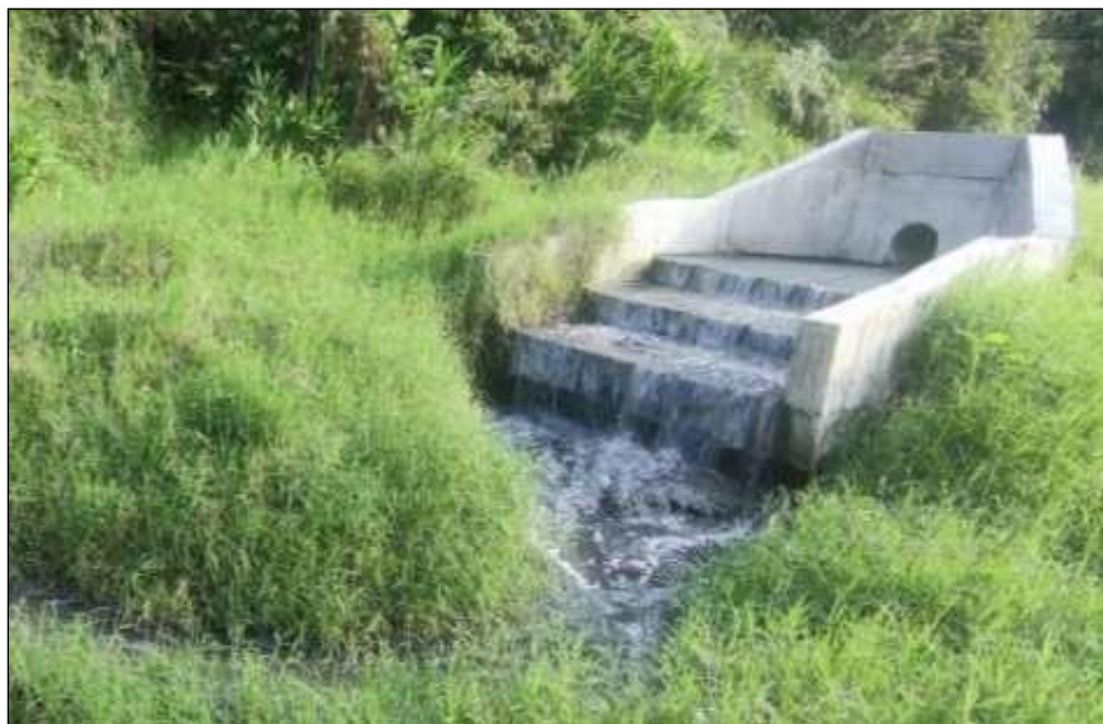
Figura 41 - Cabezal de descarga vertimiento PTAR Santa María Principal.
