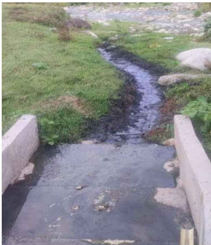
Figura 44 - Cabezal de descarga vertimiento PTAR Santa María La Nueva.
