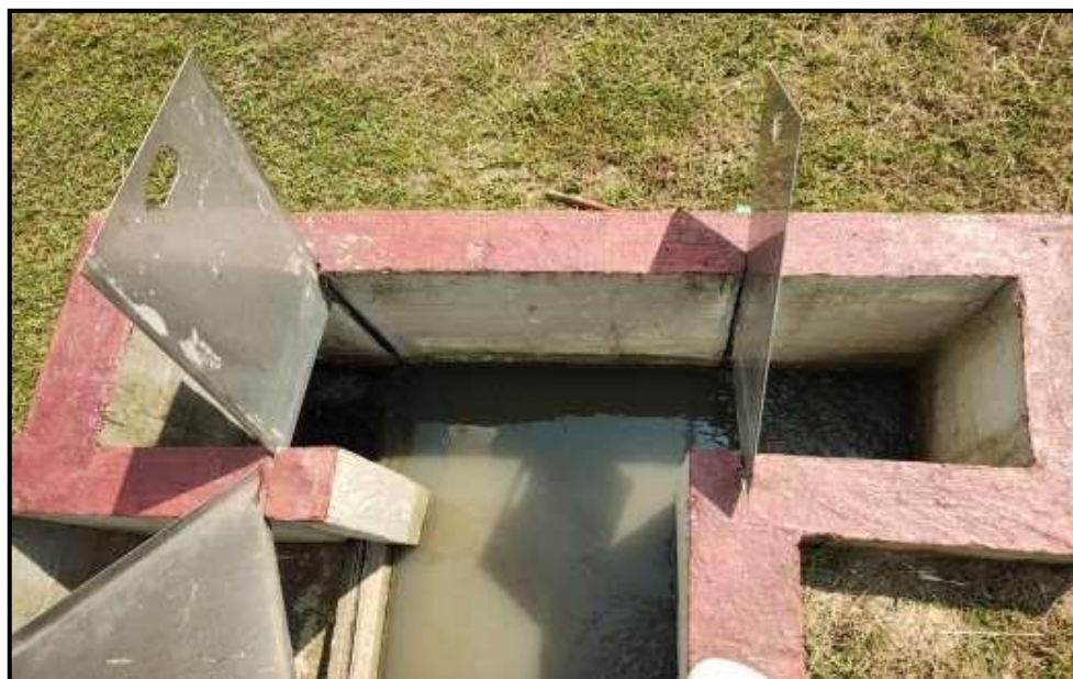
Figura 11 - Canal de repartición de caudales en PTAR Santa María Principal
