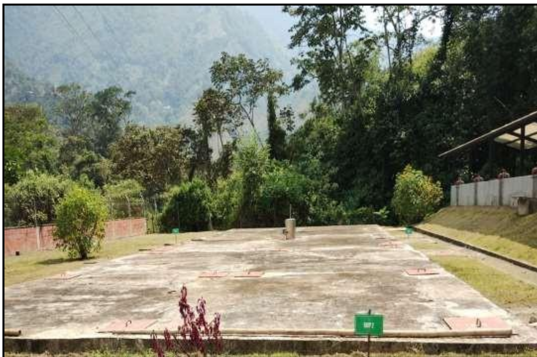
Figura 14 - Filtros anaerobios de flujo ascendente – FAFA en PTAR Santa María Principal
