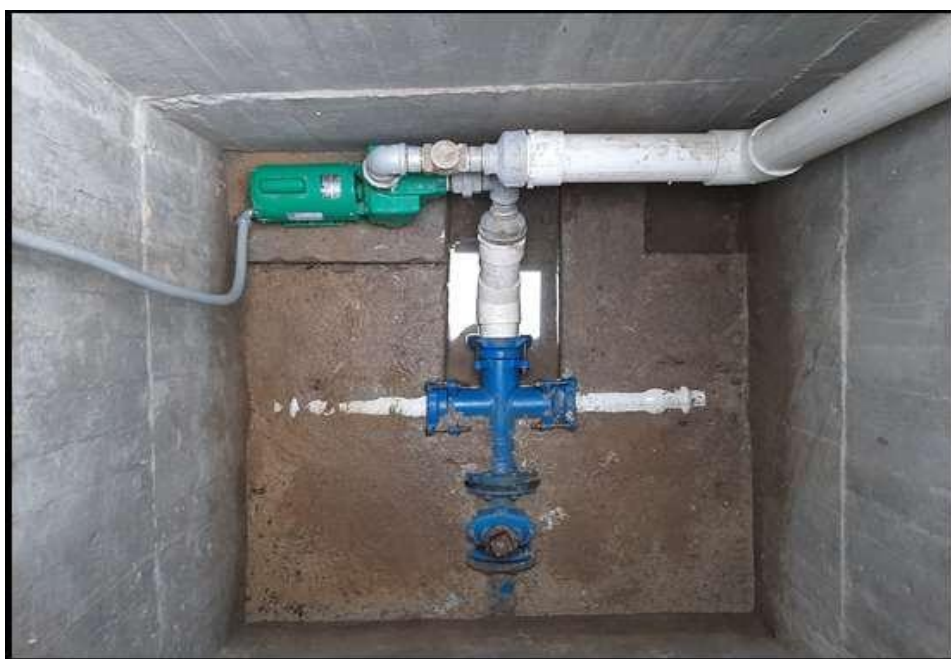
Figura 16 - Pozo de bombeo con electrobomba en línea hacia lecho de secado de lodos – FAFA en PTAR Santa María Principal.
