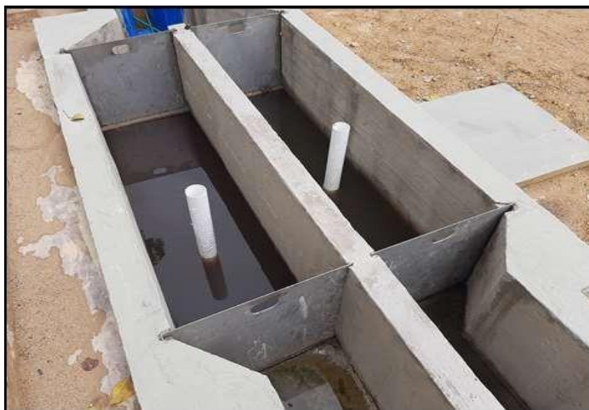
Figura 8 - Unidades para desarenado en PTAR Santa María Principal
