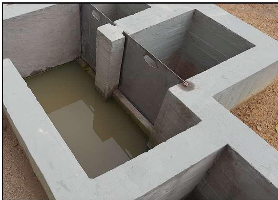
Figura 23 – Aliviadero intermedio aguas con tratamiento primario en PTAR Santa María La Nueva
