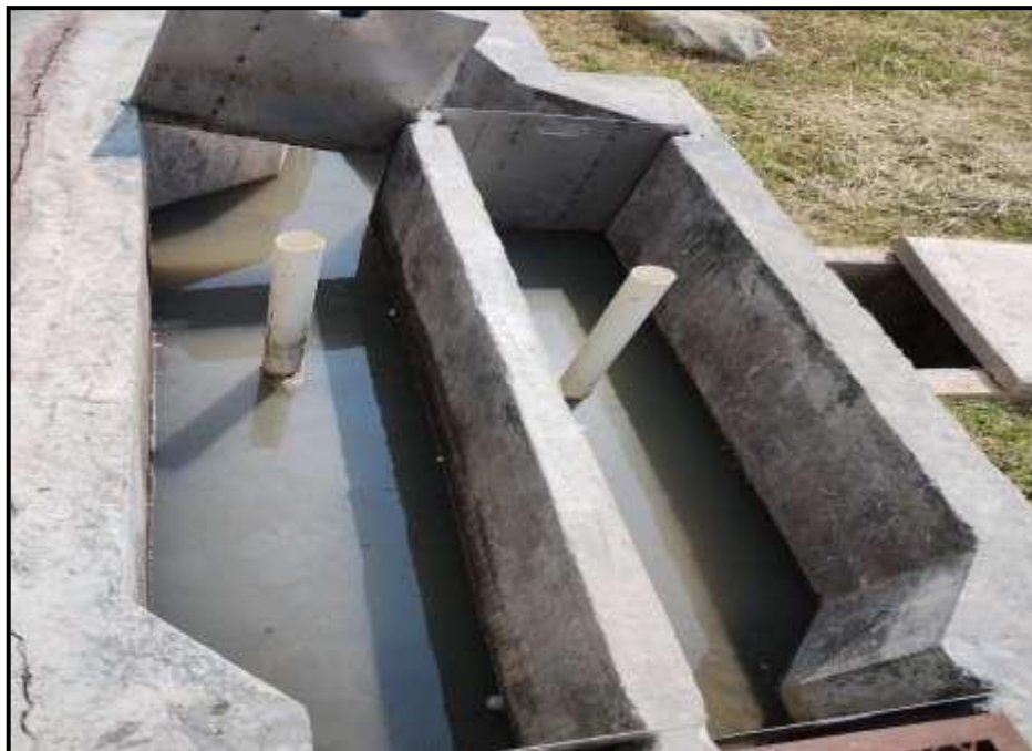
Figura 21 – Unidades para desarenado en PTAR Santa María La Nueva
