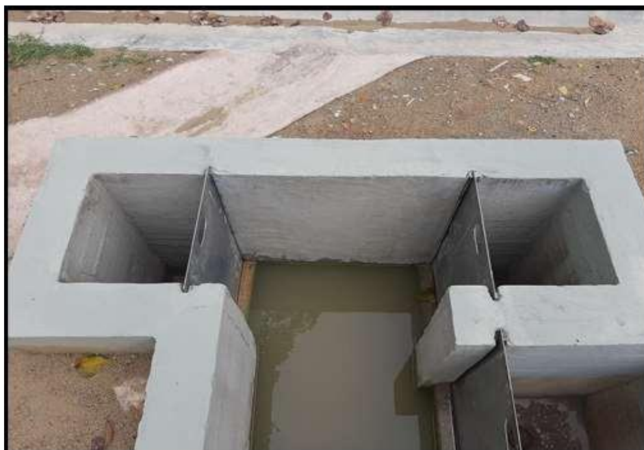
Figura 24 – Canal de repartición de caudales en PTAR Santa María La Nueva
