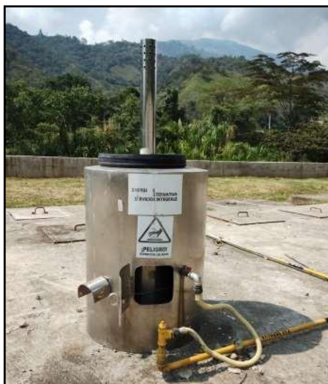
Figura 31 – Unidad de quemado de biogas en PTAR Santa María La Nueva
