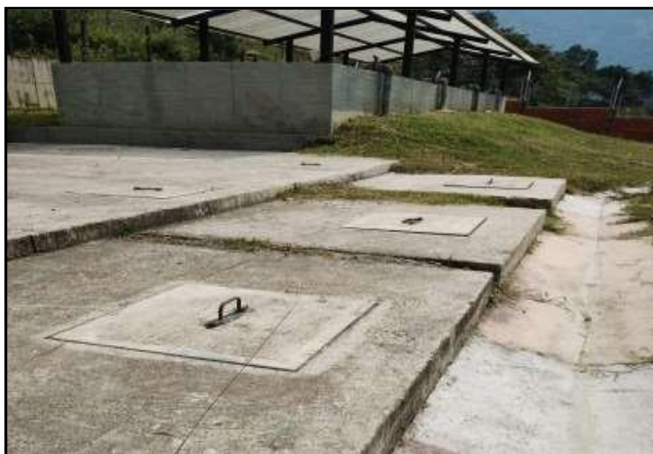
Figura 26 – Cajilla de válvulas en RAFP y FAFA en PTAR Santa María La Nueva
