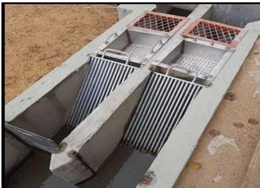
Figura 20 – Rejillas de cribado en paralelo en PTAR Santa María La Nueva
