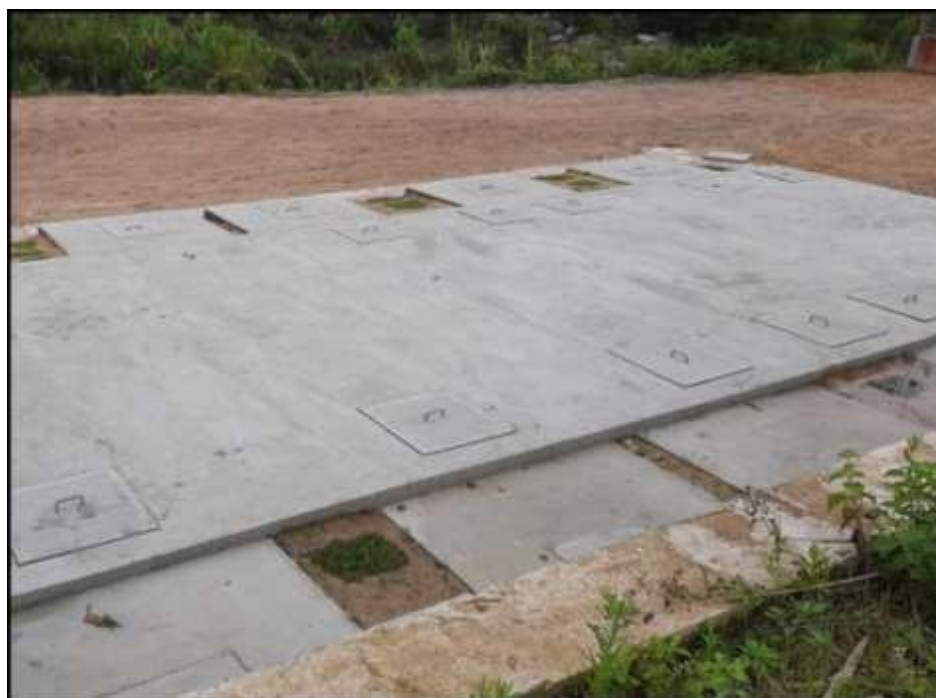
Figura 25 – Reactores anaerobios de flujo pistón – RAFP en PTAR Santa María La Nueva
