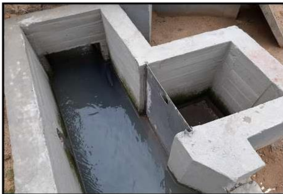
Figura 6 - Aliviadero inicial de aguas crudas en PTAR Santa María Principal
