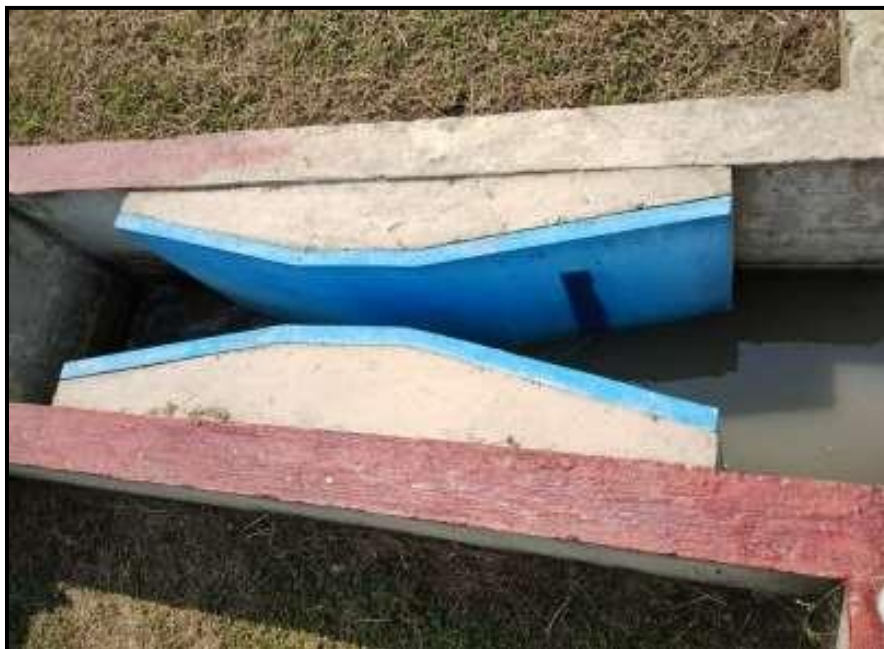
Figura 9 - Aforador de caudal – canaleta parshall – en PTAR Santa María Principal
