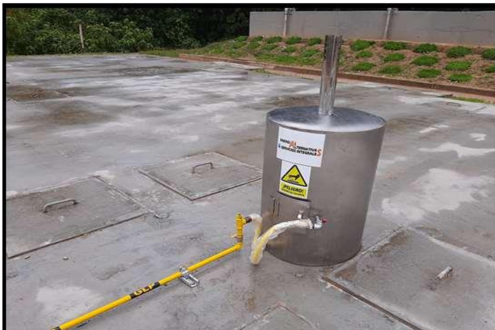
Figura 18 - Unidad quemadora de biogás en PTAR Santa María Principal
