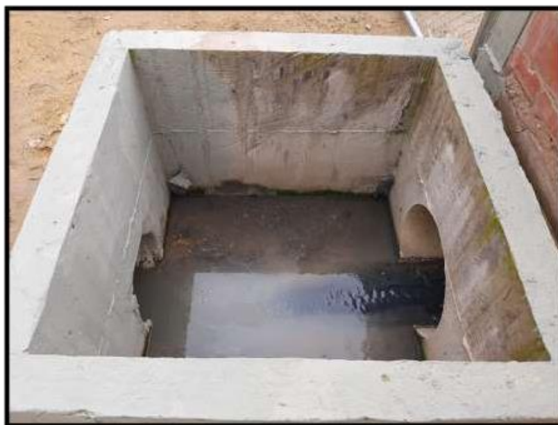
Figura 5 - Aliviadero inicial de aguas lluvias en PTAR Santa María Principal
