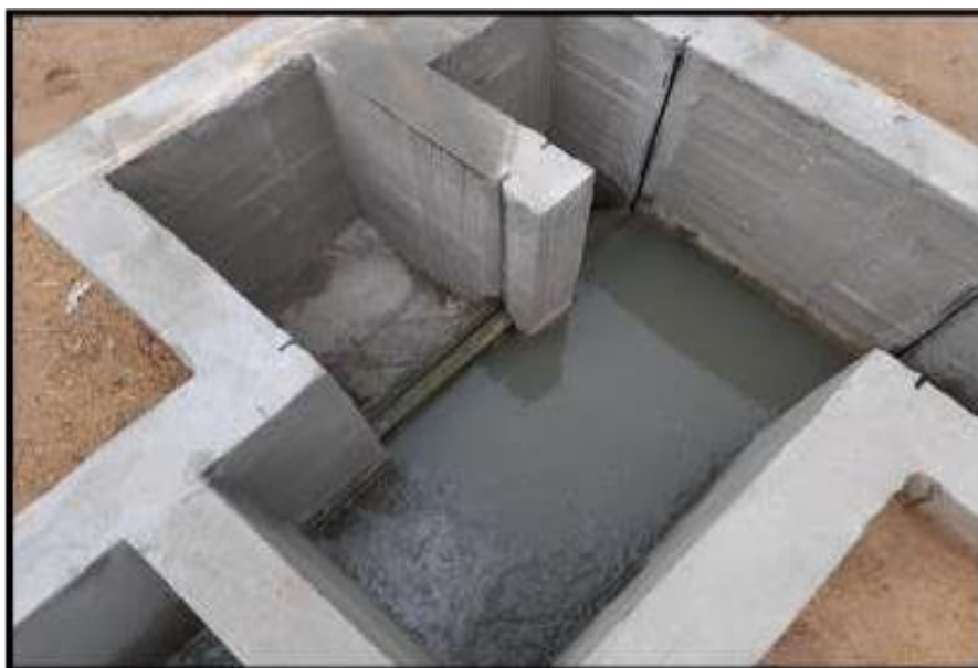
Figura 10 - Aliviadero intermedio de aguas con tratamiento primario en PTAR Santa María Principal
