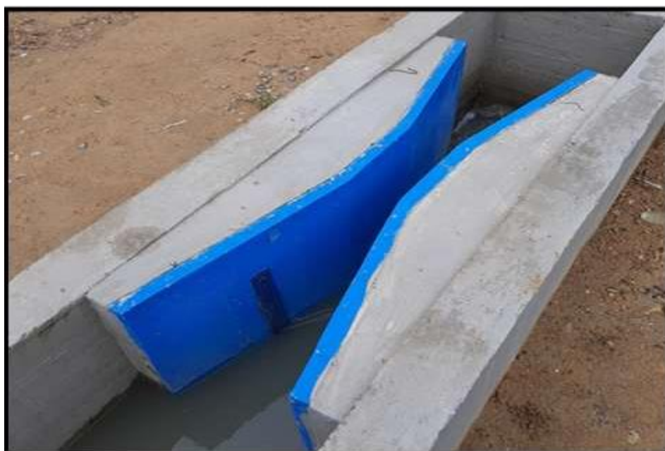
Figura 22 – Aforador de caudal – canaleta parshall - en PTAR Santa María La Nueva
