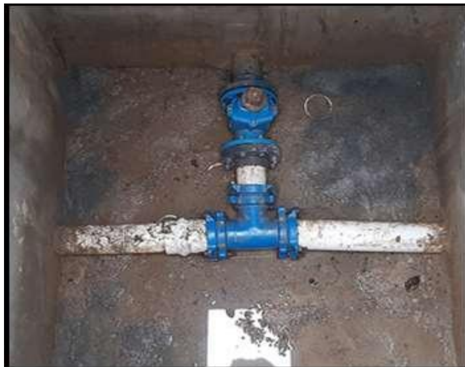
Figura 27 – Válvula de evacuación de lodos del RAFP en PTAR Santa María La Nueva
