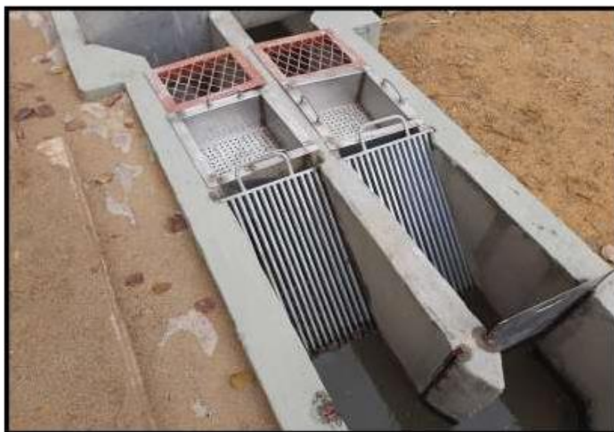
Figura 7- Rejillas de cribado en paralelo en PTAR Santa María Principal
