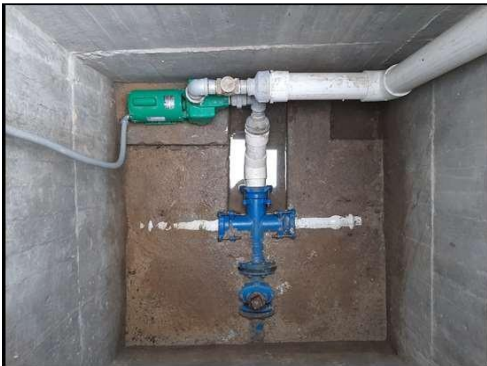
Figura 29 - Pozo de bombeo con electrobomba en línea hacia lecho de secado de lodos – FAFA en PTAR Santa María La Nueva.
