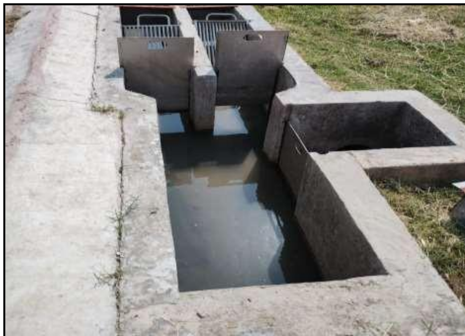
Figura 19 - Aliviadero inicial de aguas lluvias en PTAR Santa María La Nueva
