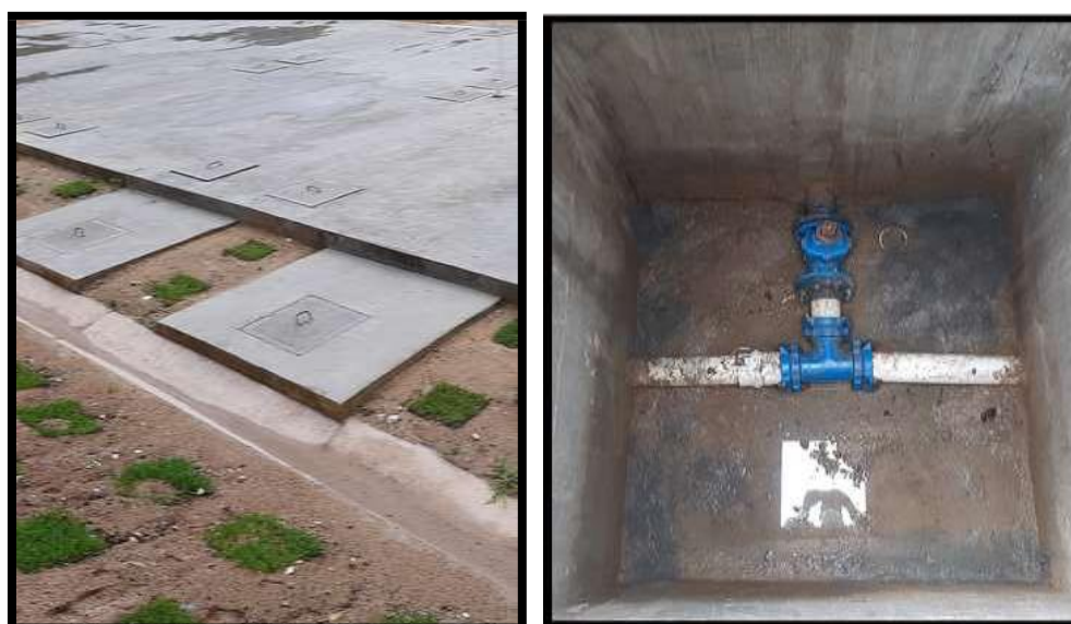
Figura 13 - Cajilla de válvulas de lodos del RAFP y FAFA en PTAR Santa María Principal
