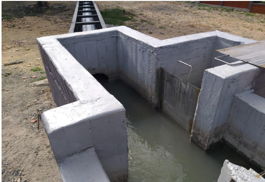
Imagen 3 Aliviadero inicial de aguas crudas, incluida su compuerta metálica de acción manual
