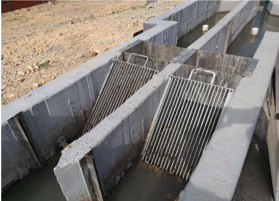
Fuente: Manual de Operación y Mantenimiento PTAR de Paicol
