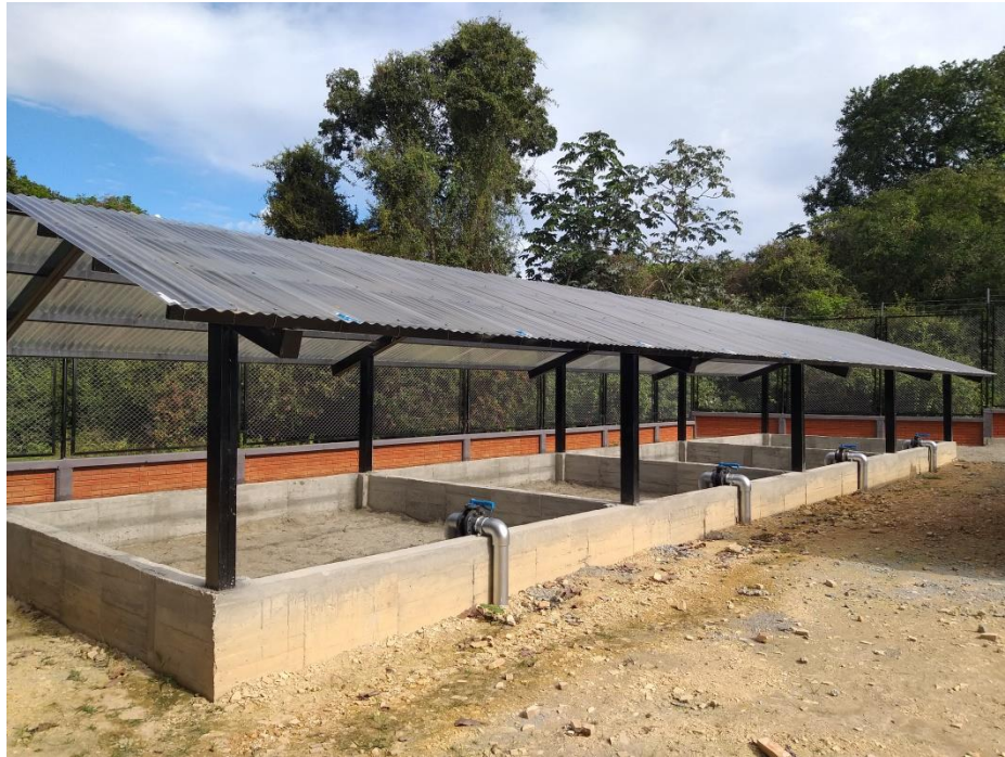
Imagen 12 Lechos de secado de lodos con cubierta
