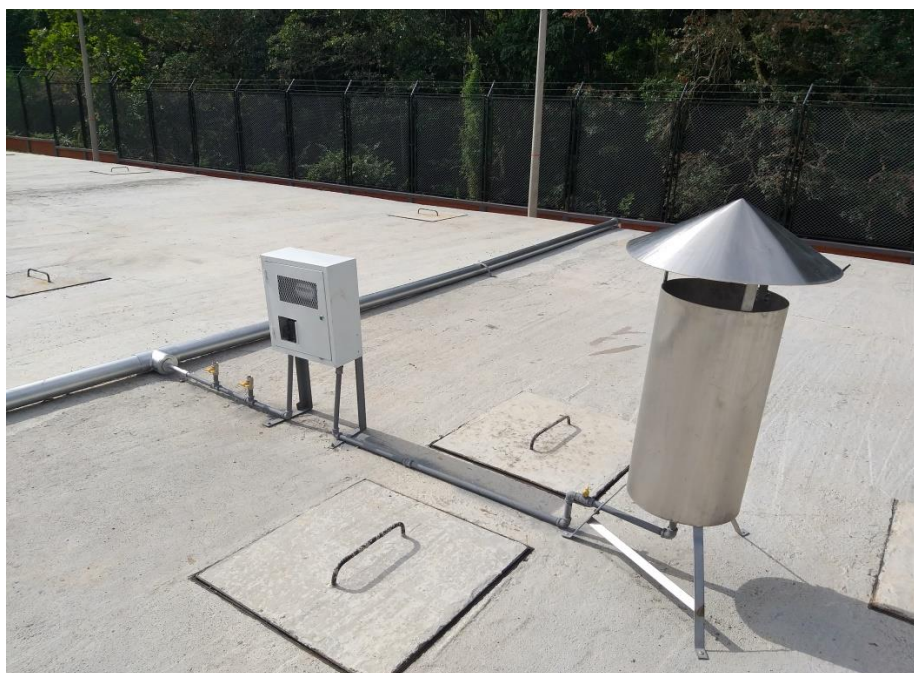
Imagen 13 Unidad quemadora de biogás en PTAR Paicol
