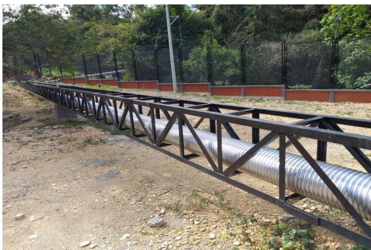
Imagen 2 Tubo de entrada a canaleta de pretratamiento en PTAR Paicol
