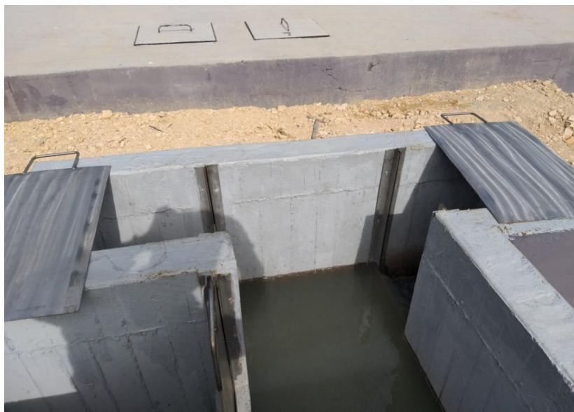
Fuente: Manual de Operación y Mantenimiento PTAR de Paicol
