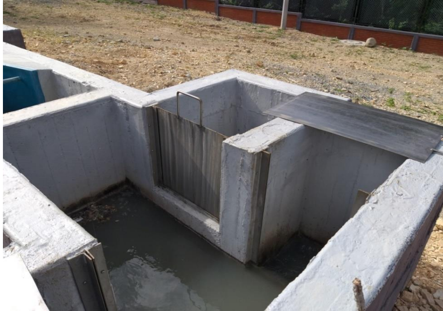
Imagen 7 Aliviadero intermedio de aguas con pretratamiento
