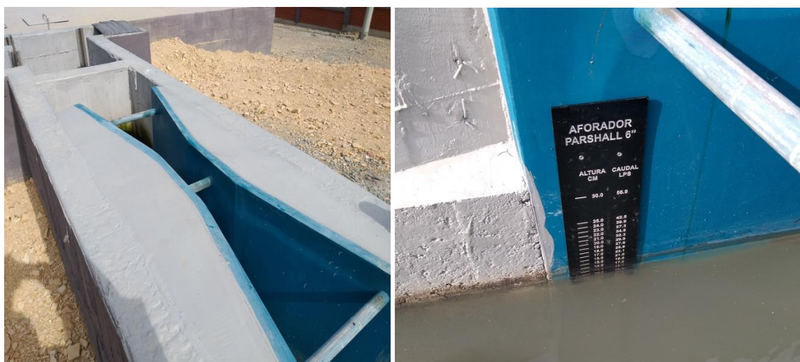
Fuente: Manual de Operación y Mantenimiento PTAR de Paicol
