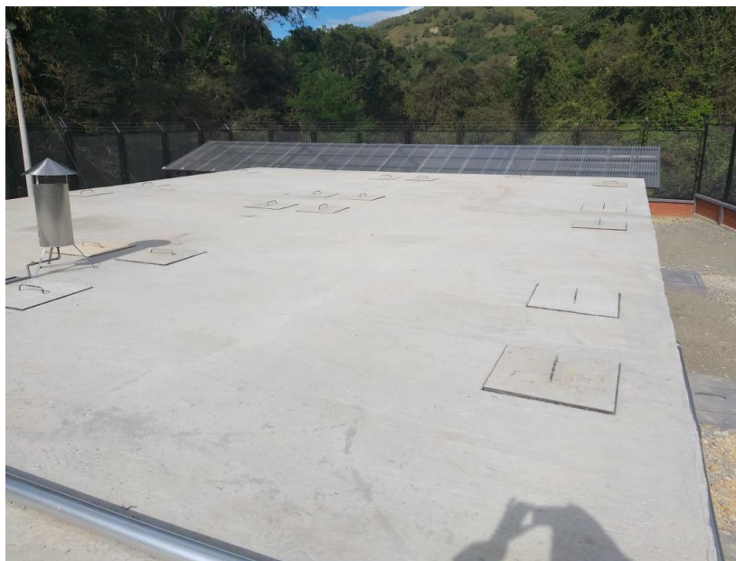
Fuente: Manual de Operación y Mantenimiento PTAR de Paicol
