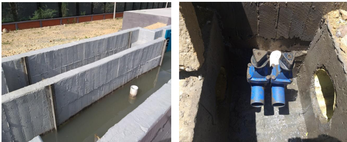
Fuente: Manual de Operación y Mantenimiento PTAR de Paicol
