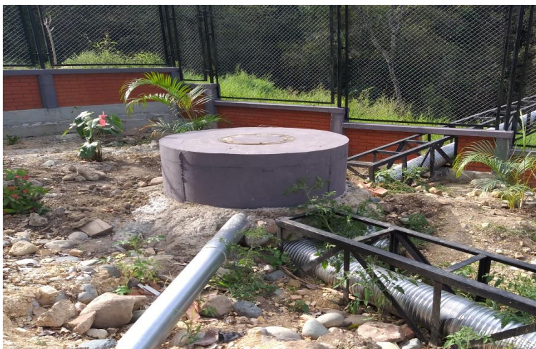
Imagen 1 Pozo de inspección dentro del perímetro de la PTAR Paicol
