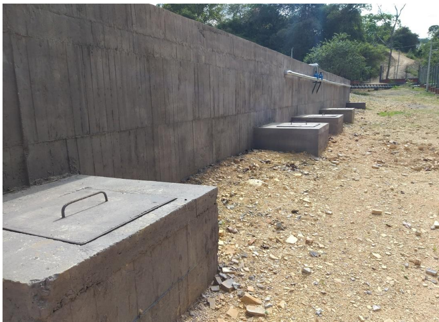
Imagen 10 Cajillas de válvulas de lodos del RAFP y del FAFA
