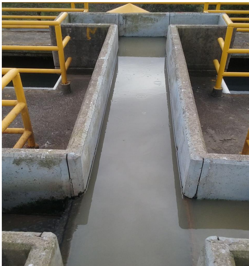
Figura 7. Canal de repartición de caudales en PTAR principal Nátaga
