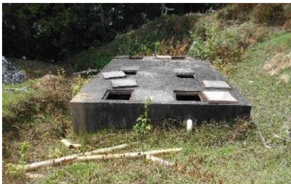
Figura 13. Tanque séptico de acción múltiple (RAFP + FAFA) en PTAR Tinajitas Nátaga
