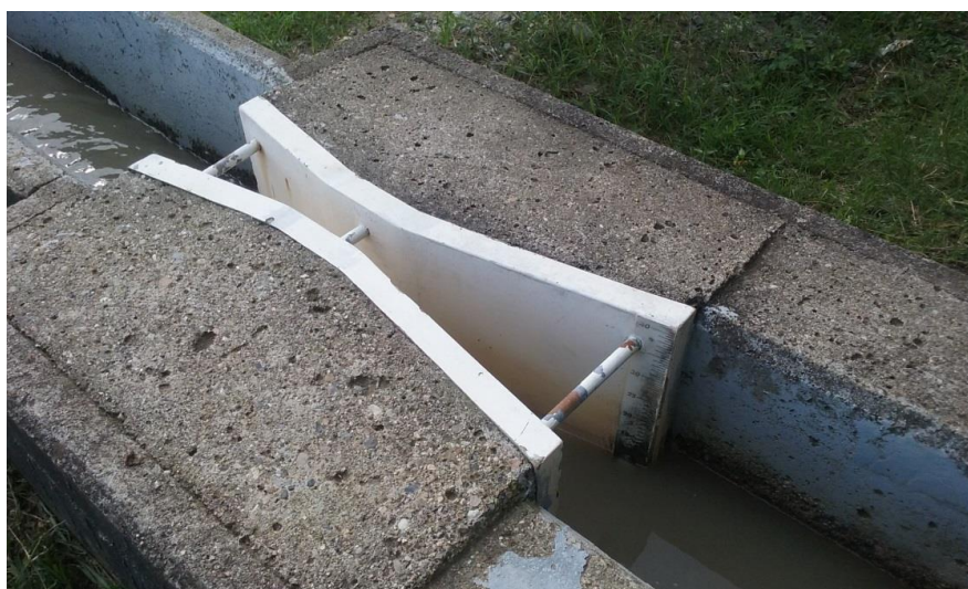
Figura 5. Aforador de caudal – canaleta parshall – en PTAR principal Nátaga
