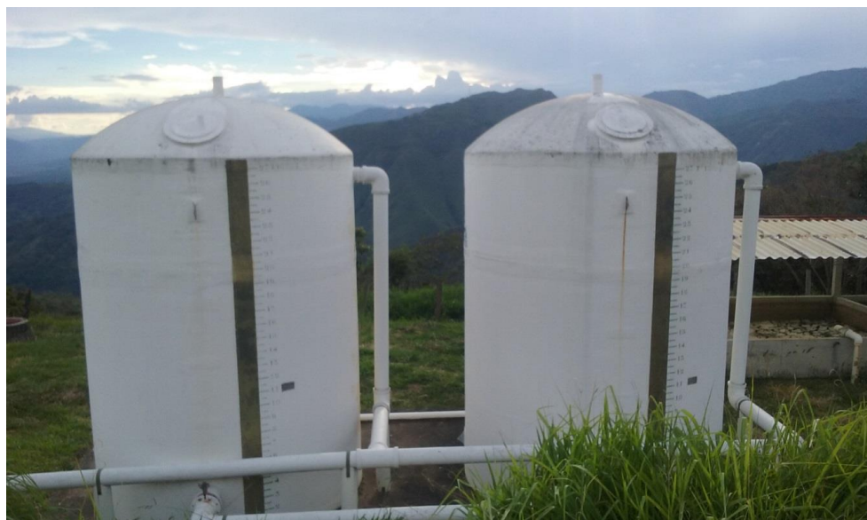
Figura 11. Filtros anaerobios de flujo ascendente – FAFA en PTAR principal Nátaga
