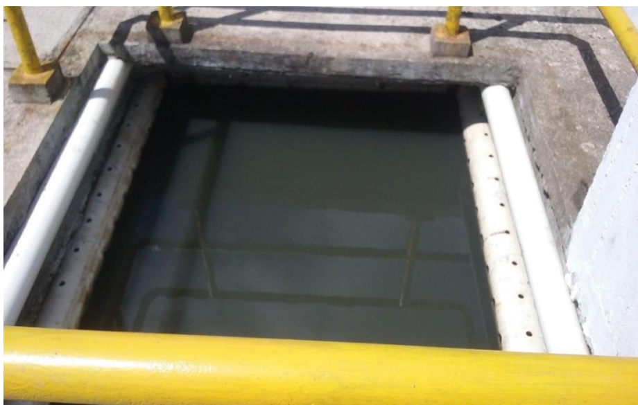
Figura 9. Detalle de un reactor anaerobio de flujo ascendente en PTAR principal Nátaga
