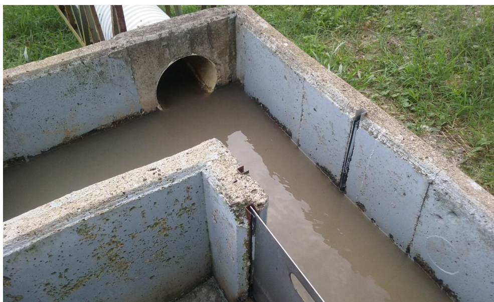
Figura 6. Aliviadero intermedio de aguas con tratamiento primario en PTAR principal Nátaga
