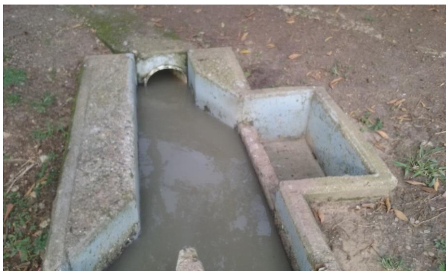
Figura 2. Aliviadero inicial de aguas crudas en PTAR principal Nátaga
