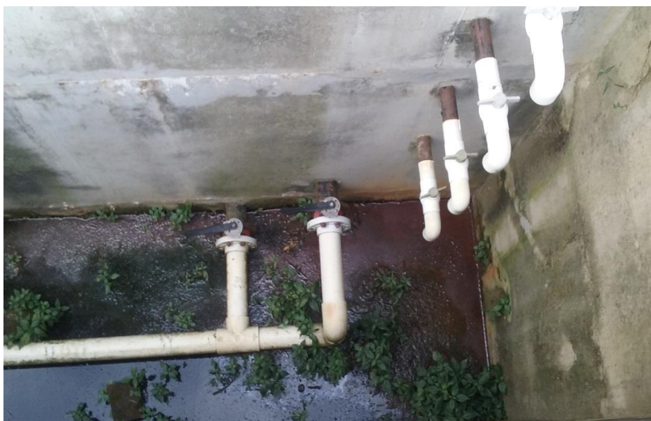
Figura 10. Detalle de las válvulas para muestreo dentro del RAFA en PTAR principal Nátaga
