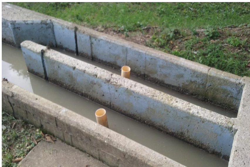
Figura 4. Unidades para desarenado en PTAR principal Nátaga
