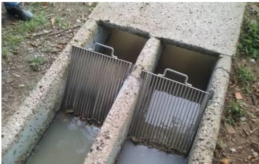
Figura 3. Rejillas de cribado en paralelo en PTAR principal Nátaga
