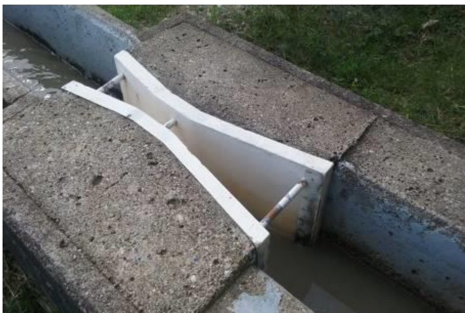
Figura 5. Aforador de caudal – canaleta parshall – en PTAR principal Nátaga
