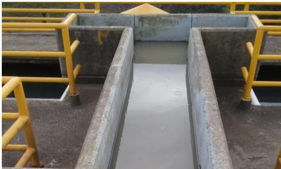
Figura 7. Canal de repartición de caudales en PTAR principal Nátaga
