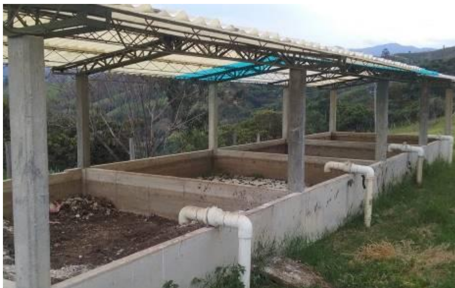
Figura 12. Lechos de secado de lodos en PTAR principal Nátaga
