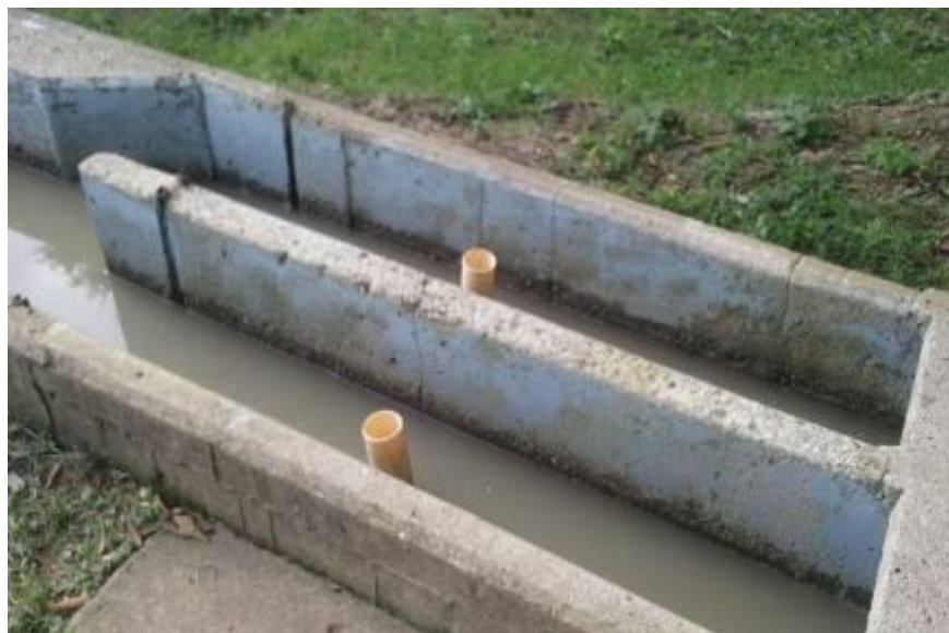
Figura 4. Unidades para desarenado en PTAR principal Nátaga
