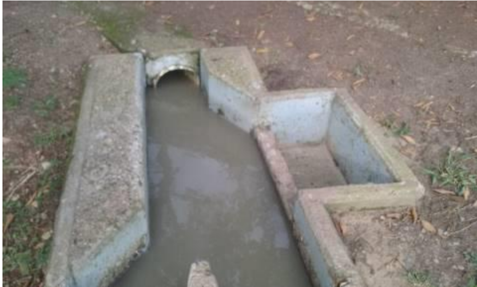
Figura 2. Aliviadero inicial de aguas crudas en PTAR principal Nataga
