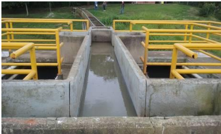
Figura 8. Reactores anaerobios de flujo ascendente – RAFA en PTAR principal Nátaga
